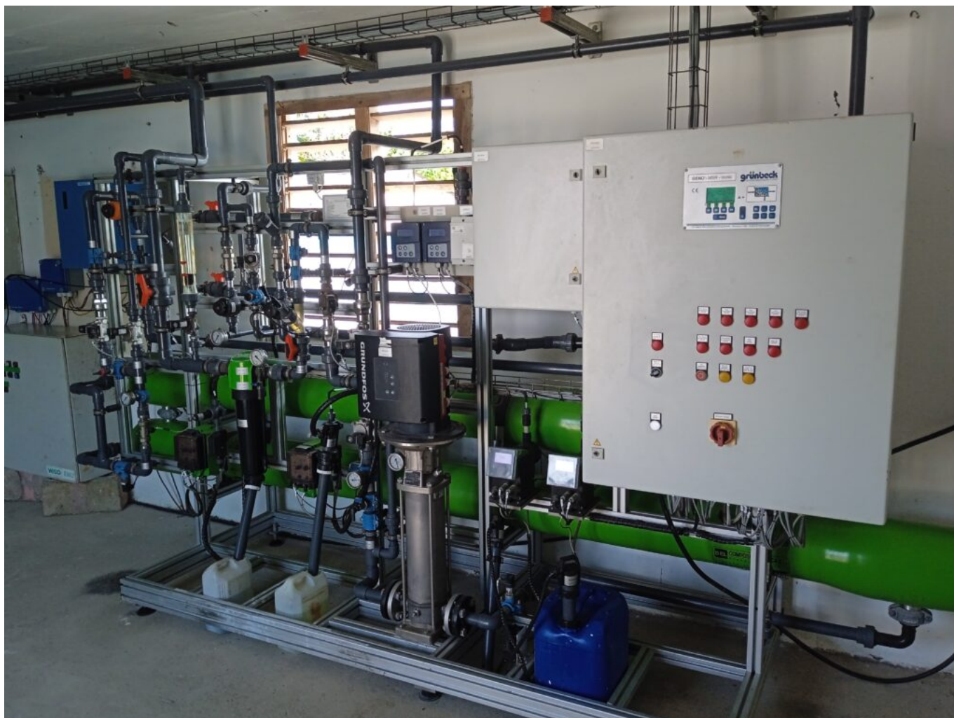
Planta potabilizadora en Cayo Ramona
